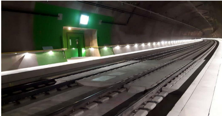
Une signalisation bien visible des chemins de fuite augmente la sécurité dans les tunnels ferroviaires. Source: SBB CFF FFS
