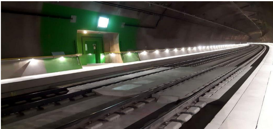
Gut sichtbare Signalisation der Fluchtwege erhöht die Sicherheit in Eisenbahntunneln. / Quelle: SBB CFF FFS
